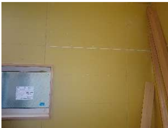
ボードに変状無し
