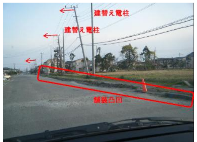
古い電柱は傾いている。 道路の舗装も凸凹となっている。
