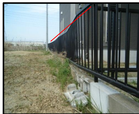
(波打ち・損壊)
