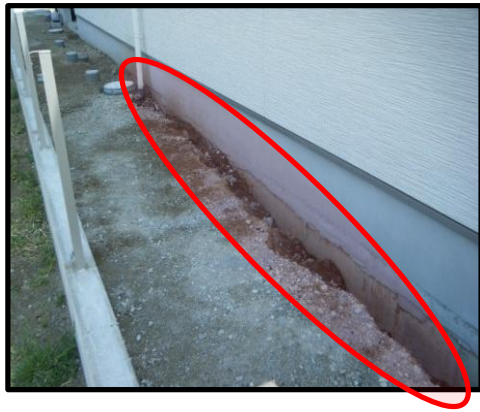
(基礎廻り墳砂跡)
