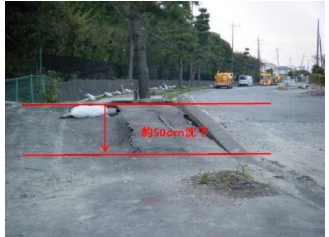
歩道が沈下しているが、埋設物のあった箇所は沈下が起こっていない。約50cm下がっている。噴砂の後も見られ、砂が一面に見られる。
