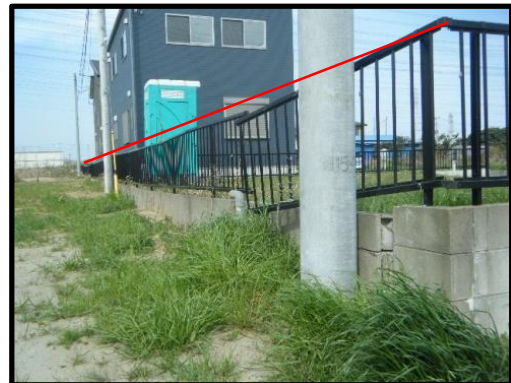
(波打ち・損壊)
