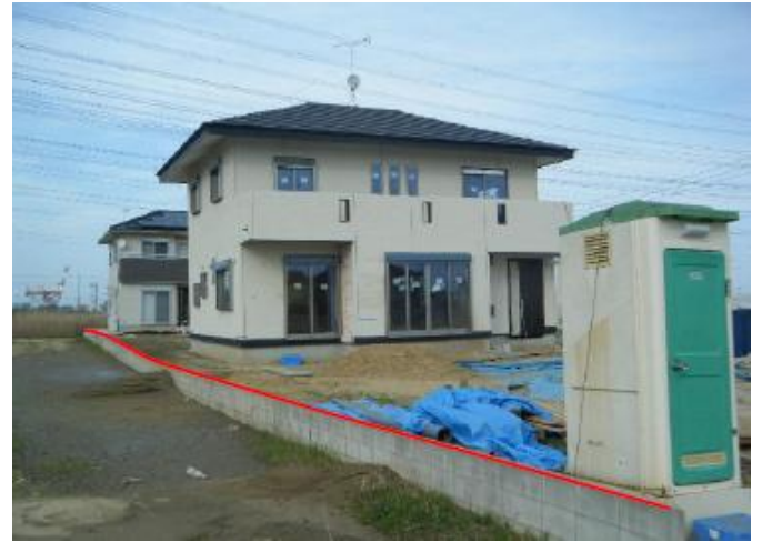
左同物件 地盤が沈下し境界ブロックが傾斜している。
