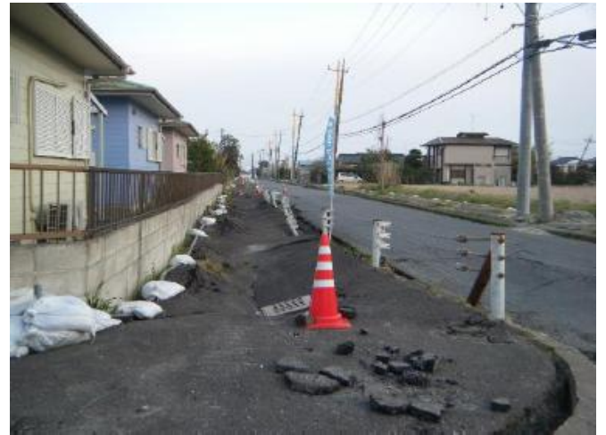
歩道が凸凹となっている。塀と歩道の間からの砂の噴砂が多かったと考えられる
