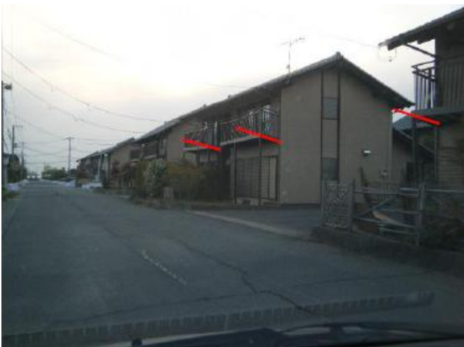
建物の住宅部分は荷重が大きいので沈下しているが、荷重の小さいバルコニーは沈下していなかった為、建物方向にバルコニーが傾斜している。
