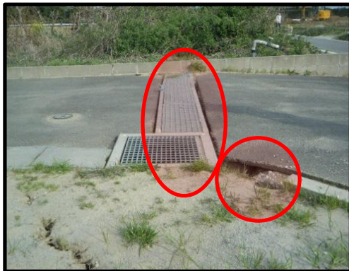
(進入路ひび割れ)
