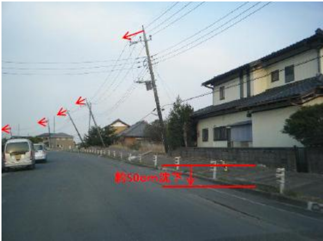
道路が50cm沈下し電柱も傾いている。
