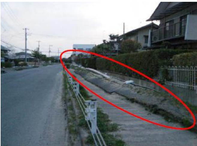
水道管が寸断され仮設水道管が配置されている。歩道 道路とも沈下 cm程見られる
